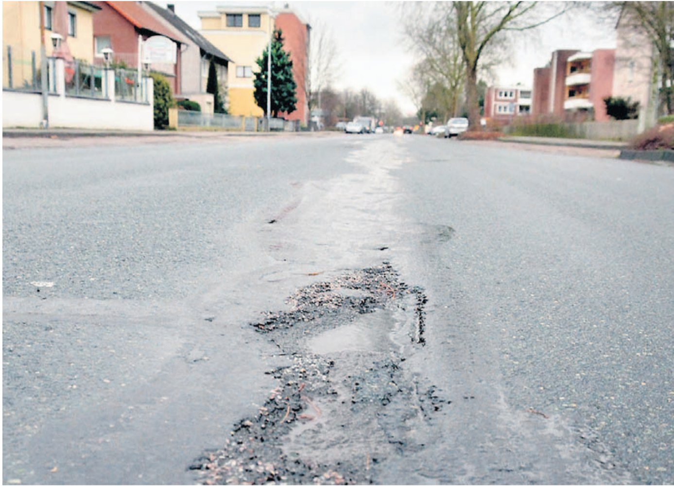
In schlechtem Zustand: die Berliner Straße, die saniert werden muss. Wer aber soll die Bauarbeiten bezahlen?
